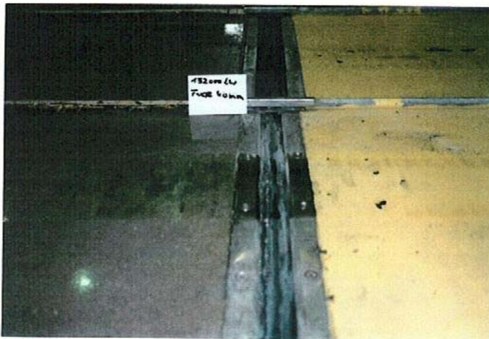
Bild 12: Oberflächen- und Profilanschlußbereiche nach über 75. 000 Lw in Versuchsphase II (20 mm Dehnung) völlig schadfrei und wasserdicht (links 152000 Lw, rechts 177200 Lw)
